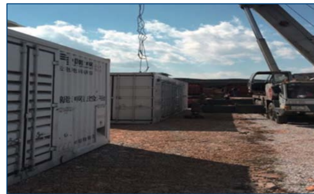
35kV/4MVA新能源测试平台
