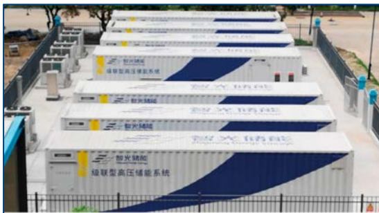
顺德某火电厂级联型高压储能项目
