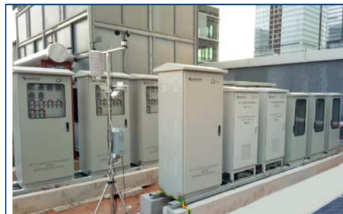
某科技生态园微网示范工程
