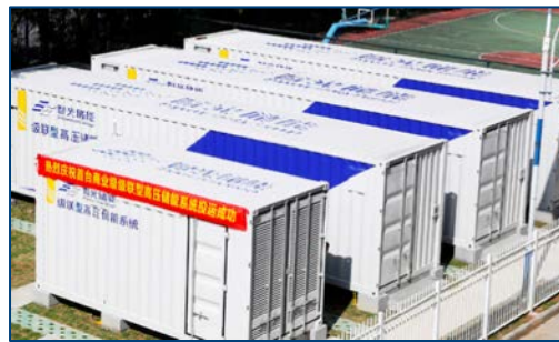
广州某工厂储能项目
