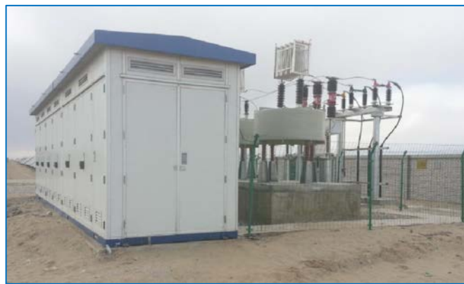
青海格尔木某光伏升压站SVG项目
