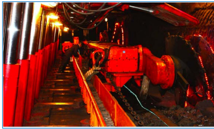
陕西某矿业集团无功补偿项目
