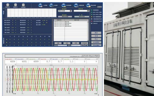
6/10kV/6MVA 储能测试平台
