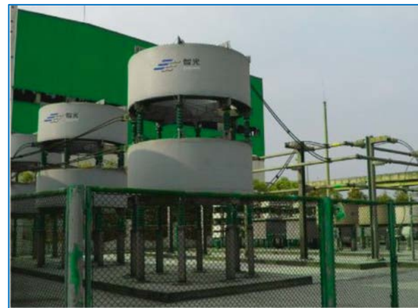
福建某不锈钢厂无功补偿项目
