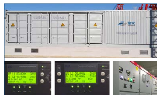
辽宁营口港岸电项目
