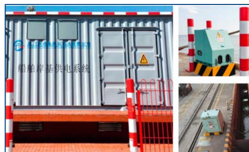
厦门港嵩屿岸电项目
