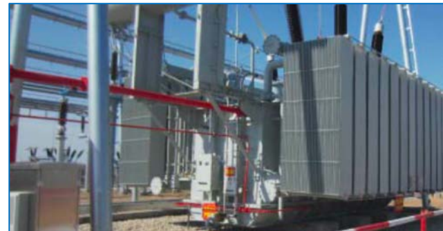
广东某变电站消弧改造项目
