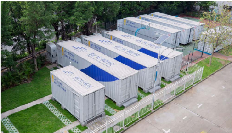
储能研究试验平台
